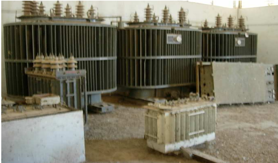
Photo n° 3 : Etat de stockage des transformateurs au sein de la RTC.
