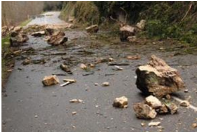
Figure 1.2 : Chutes de blocs sur le CW35 à « Amalou », wilaya de Bejaia.
