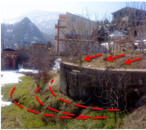
Figure 1.32 : Renversement du mur de soutènement
