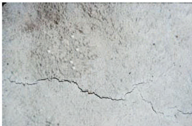
Figure I.10. Fissuration due au retrait plastique ressemblant à une déchirure dans la surface de béton.
